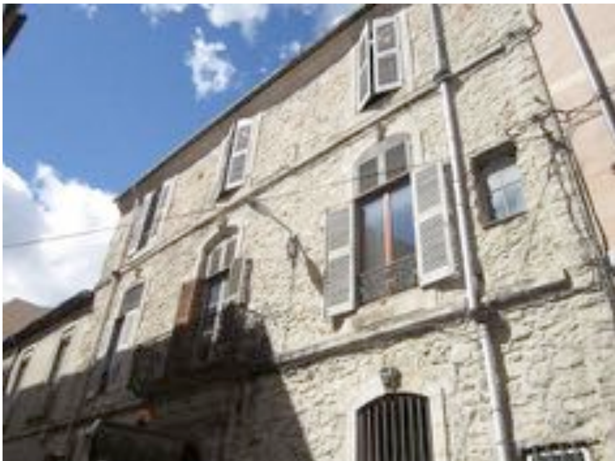
Vue d'ensemble de la façade sur rue. Exemple de restauration faite sans encadrement architectural.
